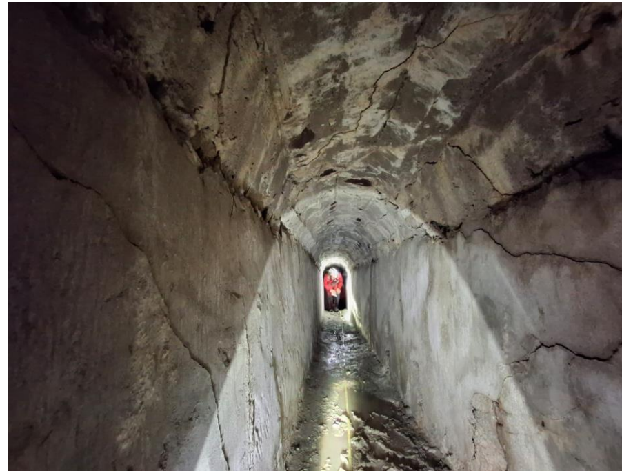
Gallerie drainante dans une zone de glissement (Saorge, 2026)
