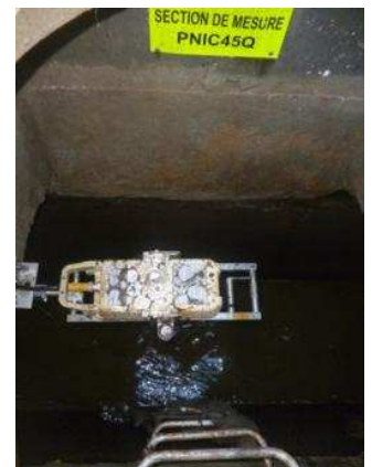
Débitmètre RADAR installé dans un collecteur visitable d'eaux
