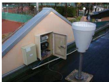
Pluviomètre situé en rive gauche du Var à Nice (Tennis des Combes)
