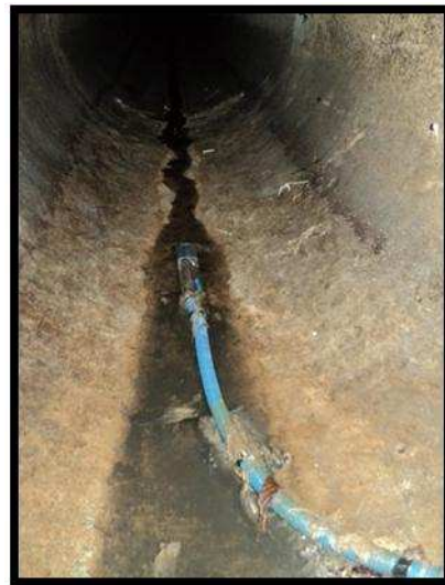
Sondes permettant de connaître le volume d'eaux usées déversé par un déversoir d'orage
