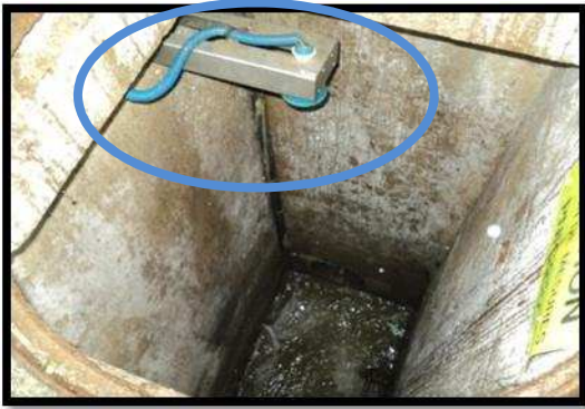
Sonde Ultra-son mesurant la hauteur de l'effluent
