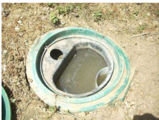
Fosse toutes eaux
