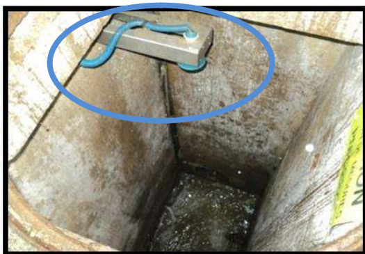
Sonde Ultra-son mesurant la hauteur de l'effluent
