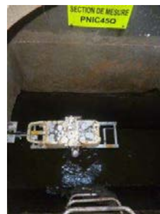
Débitmètre RADAR installé dans un collecteur visitable d'eaux usées
