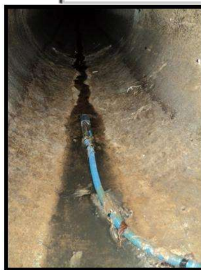
Sondes permettant de connaître le volume d'eaux usées déversé par un déversoir d'orages
