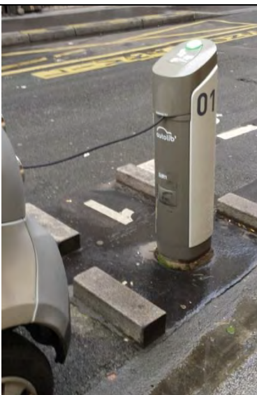
Borne de recharge électrique
