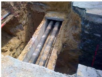
Réseau en caniveau
