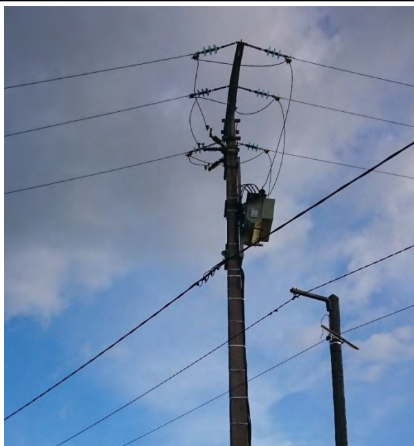
Réseau aérien BT torsadé sur support HTA
