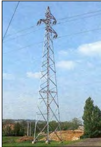
Réseau aérien HTB de 63 kV sur pylône
