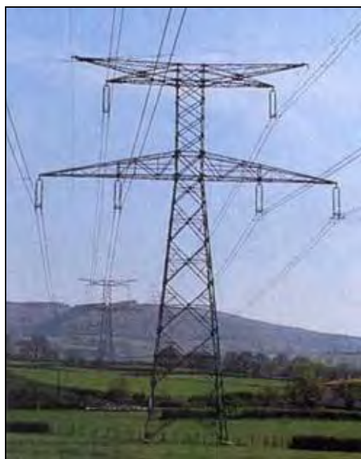
Réseau aérien HTB de 400 kV
