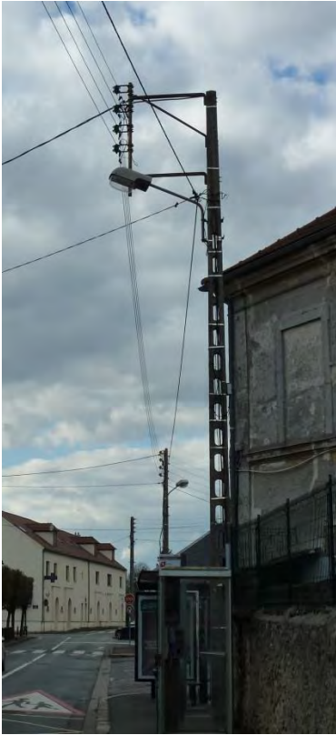
Eclairage public BT sur support béton commun
