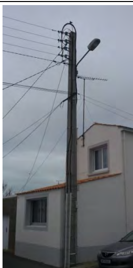
Réseau aérien BT sur support commun
