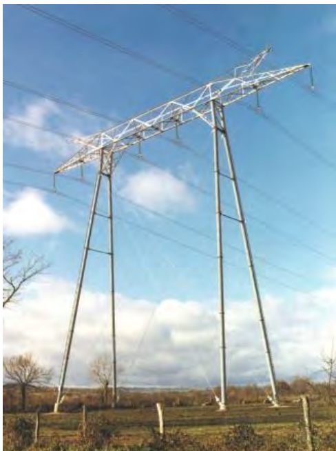
Réseau aérien HTB de 225 kV
